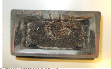
BEISPIEL VERSCHMUTZTE BRENNSCHALE
