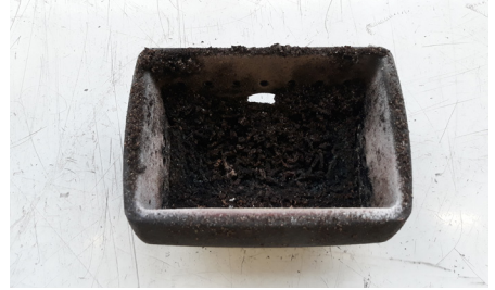
BEISPIEL VERSCHMUTZTE BRENNSCHALE
